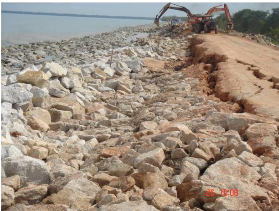
Fig. 5.1 – Masalah runtuh struktur lapis lindung yang berlaku semasa projek pengawalan hakisan pantai.
